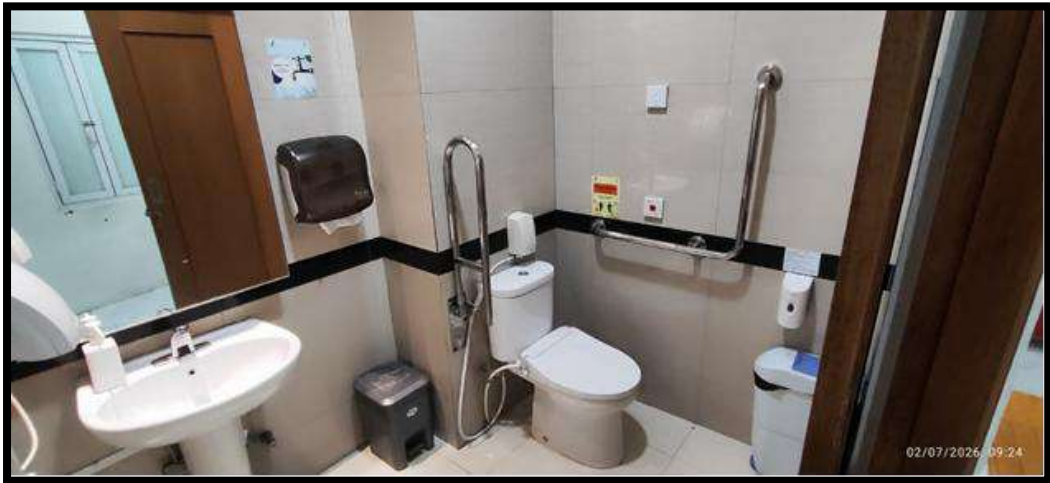
Gambar 7. Toilet Khusus Kelompok Rentan
